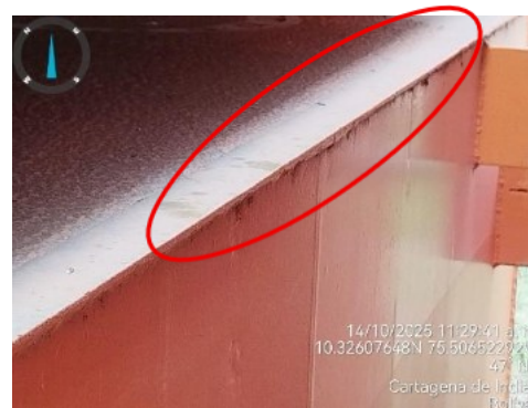
Foto No. 4: Daños de oxidación en módulos por exposición al ambiente
