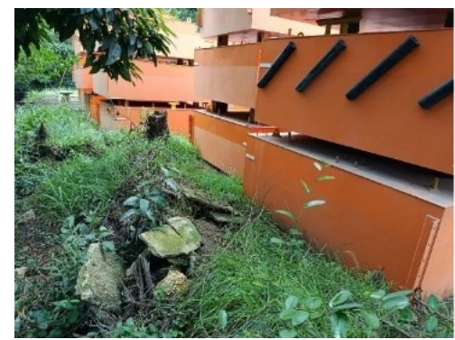
Foto No. 20: Módulos apoyados y expuestos sobre la capa vegetal
