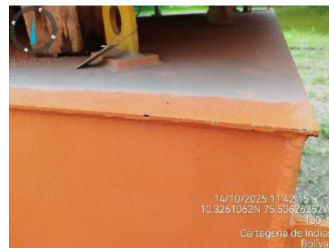
Foto No. 6: Daños de oxidación en módulos
