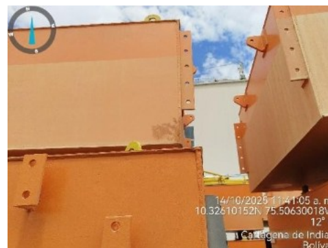
Foto No. 8: afectación en las capas exteriores (decoloración y tiza) en la pintura de los módulos
