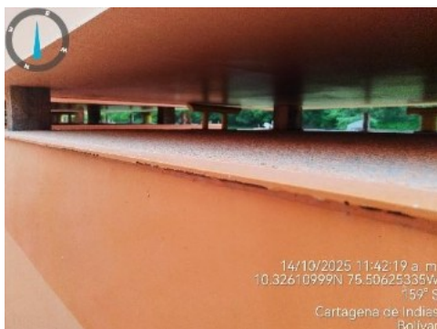
Foto No. 7: módulos apoyados sobre la misma estructura sin protección
