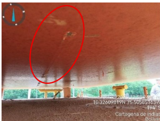
Foto No. 11: Deterioro en pintura en sección inferior
