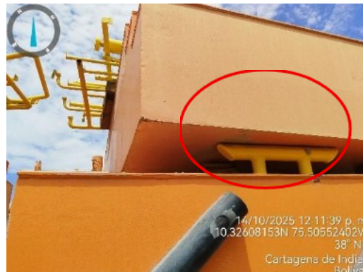
Foto No. 10: módulos sin apoyo de protección
