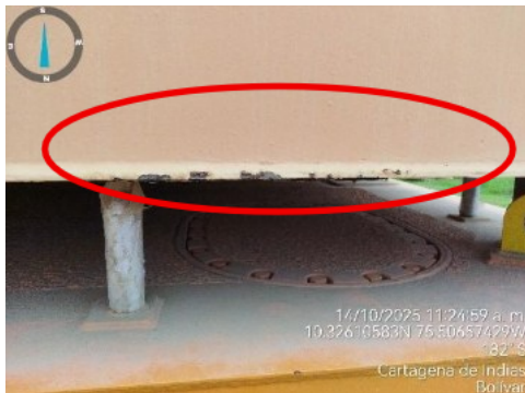
Foto No. 3: Daños de oxidación en módulos por exposición al ambiente y reubicación
