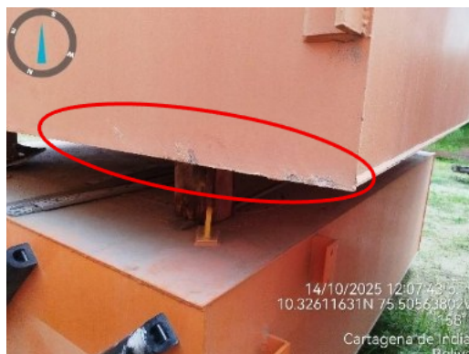
Foto No. 12: Afectación por oxidación
